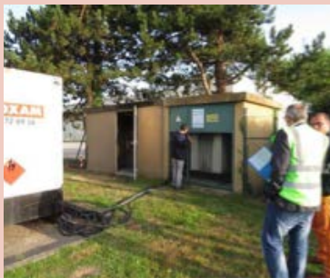
Vue sur le local du poste HT/BT en limite de propriété
