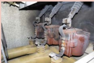
Origine de l'incident
