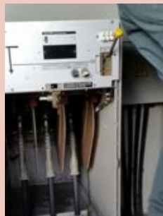
Cellule sectionneur du transformateur
