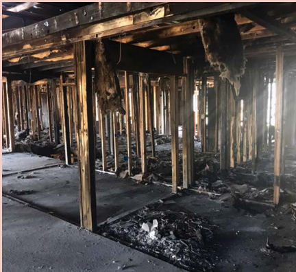
Local de stockage des batteries lithium détruit suite à l'incendie
