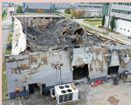
Atelier de production détruit suite à l'incendie
