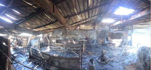
Incendie dans une entreprise suite à un travail par point chaud sur le toit.
