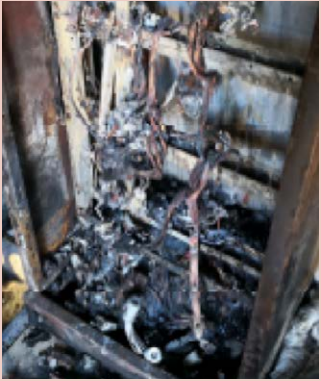
Incendie sur batteries de condensateurs
