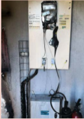
Dommages sur armoire électrique
